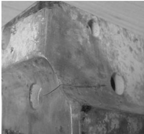
شکل ۷- نمایی از ترک ایجاد شده در قطعه اتصال در هنگام سرویس.
